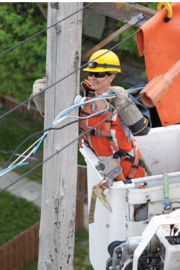
Jessica Hadfield, une monteuse de lignes, répare une ligne de façon sécuritaire. Photo reproduite avec l'aimable autorisation de Manitoba Hydro.
