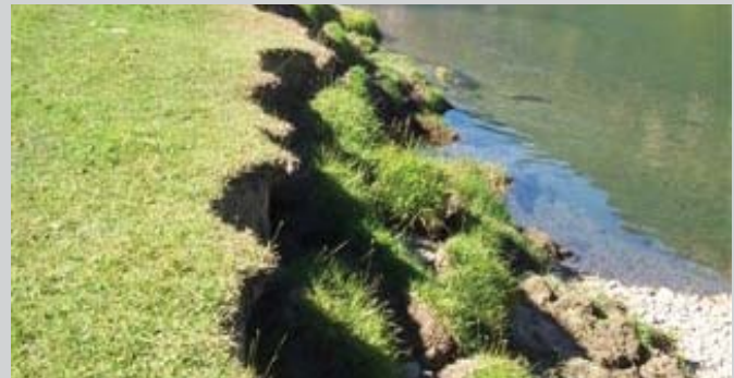
Une vue de l'érosion importante qui touche les rives de la rivière Slokan. Les travaux de restauration, financés par la Columbia Power Corporation, visent à ralentir et même réparer les dommages qui en résultent.
