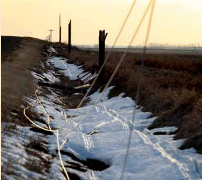
Une tempête printanière, dans le sud de l'Alberta, a causé des dommages importants aux lignes électriques de FortisAlberta.
