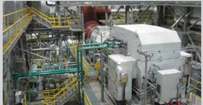
La nouvelle génératrice à turbine à vapeur et d'autres systèmes auxiliaires de la centrale de Fort Nelson.
