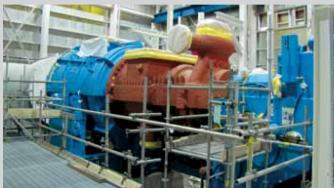
La turbine à vapeur et la génératrice du groupe de cogénération à la biomasse, à l'usine de NewPage Port Hawkesbury (NPPH).
