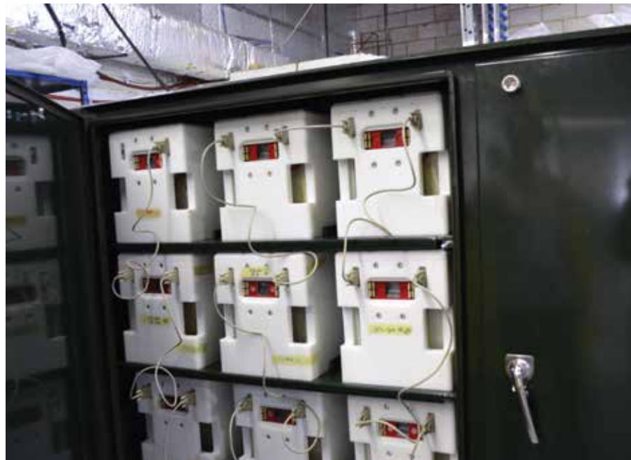
Le système de stockage d'énergie communautaire de Toronto Hydro a été développé avec une batterie au lithium-ion utilisée pour les applications du réseau de distribution. Il se compose de batteries, de commandes et de systèmes de communication reliés au réseau. Il a pu voir le jour grâce au financement de l'innovation. Photo reproduite avec l'aimable autorisation de Toronto Hydro.
