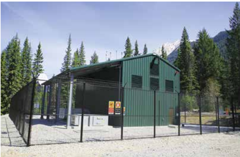
Vue de l'extérieur de l'installation de stockage de l'énergie de BC Hydro and Power Authority, située à Field. Photo reproduite avec l'aimable autorisation de BC Hydro et Power Authority.
