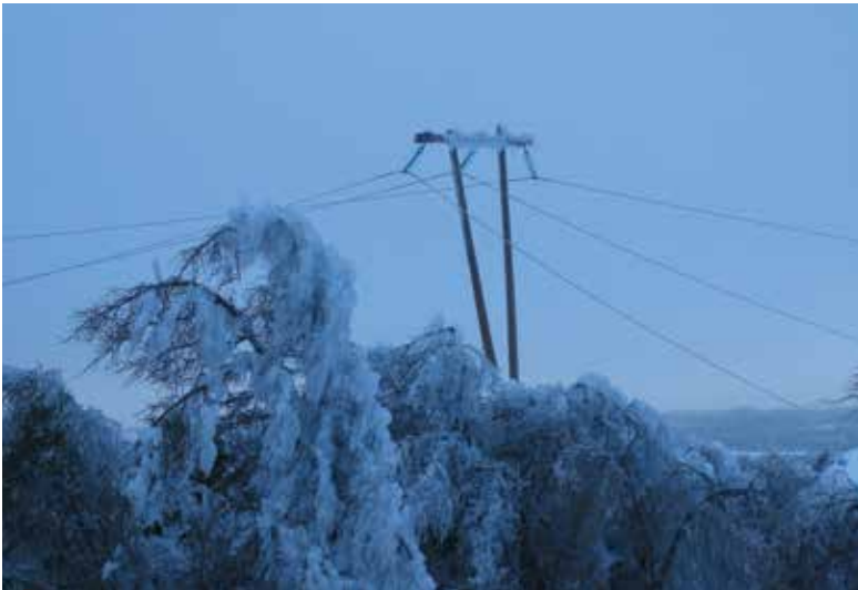
Dégâts causés par des pluies verglaçantes à Terre-Neuve. Photo reproduite avec l'aimable autorisation de Newfoundland Power inc.
