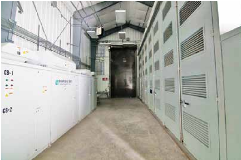
Vue de l'intérieur de l'installation de stockage de l'énergie de BC Hydro and Power Authority, située à Field. Photo reproduite avec l'aimable autorisation de BC Hydro et Power Authority.
