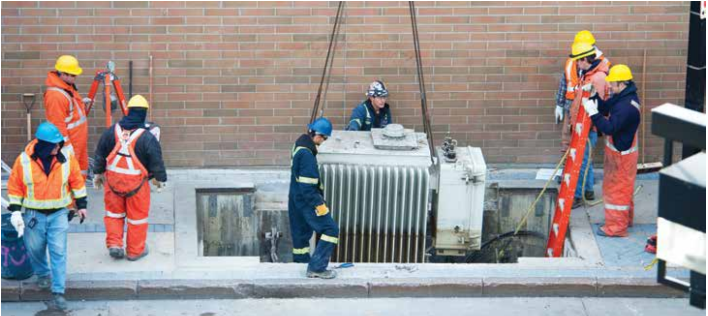
Les employés de Manitoba Hydro installent un nouvel équipement dans une chambre, près de l'avenue Graham dans le centre-ville de Winnipeg. Cette installation fait partie des mesures de renouvellement des infrastructures de l'entreprise. Photo reproduite avec l'aimable autorisation de Manitoba Hydro.
