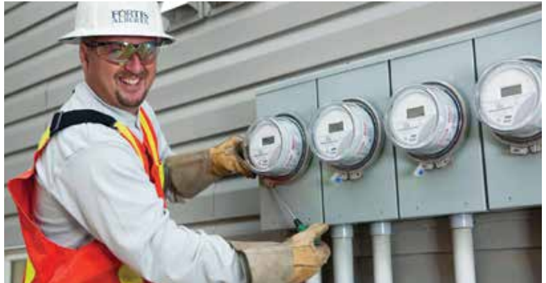
Pete Patton, monteur de lignes chez Toronto Power, installe un compteur automatique. Photo reproduite avec l'aimable autorisation de FortisAlberta inc.
